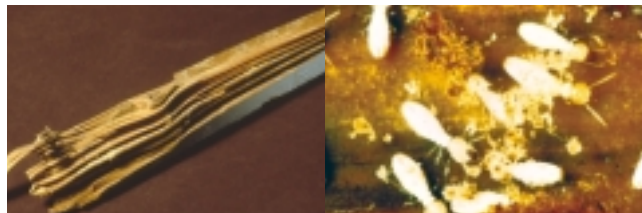
Madera afectada por termitas
